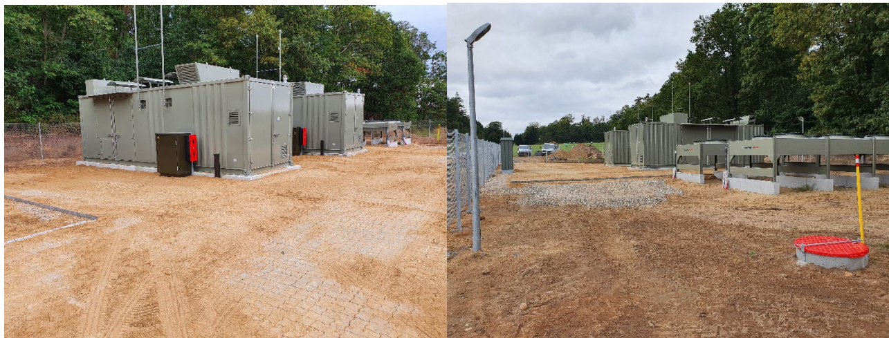
Figur 10- foto til venstre viser 2 kompressor-containerer med tilhørende el-skab (foran) og kølere (bagerst). Foto til højre viser køleanlæg (forrest) og 2 kompressor-containerer og el-skab til venstre (mod hegnet).
