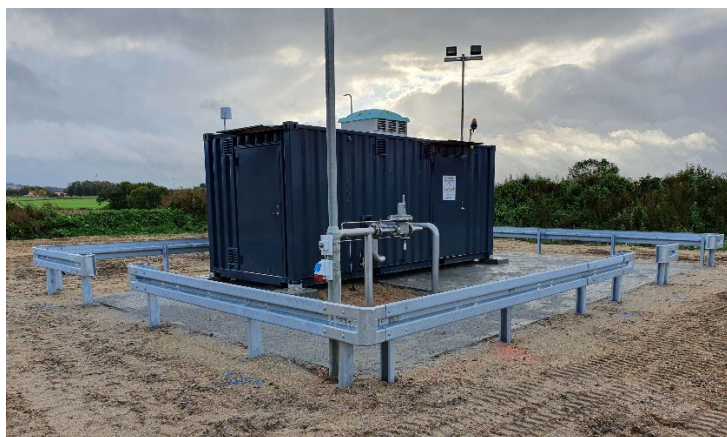
Figur 9 - Foto som viser eksempel på en BMR-station
